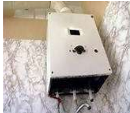
Фото 6. Угарный газ, образующийся в результате неправильной эксплуатации газового оборудования
