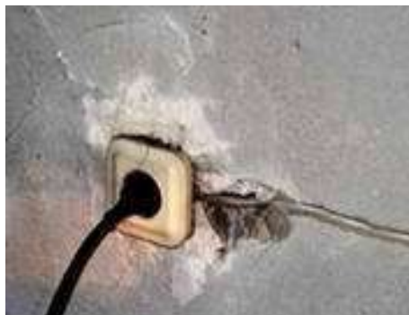
Фото 2. Нарушение правил прокладки внутренней электрической сети
